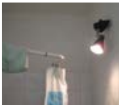
Branchement électrique dangereux
