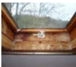
Absence de protection contre les infiltrations d'eau
