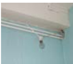
Éclairage insuffisant et dangereux
