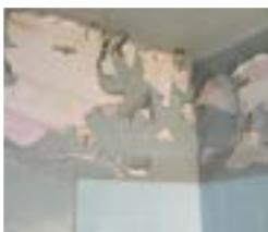
Peinture écaillée contenant du plomb
