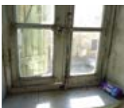
Menuiserie en mauvais état
