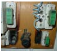
Branchements d'électricité vétustes
