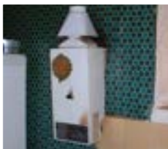
Absence de dispositif d'évacuation des gaz brûlés
